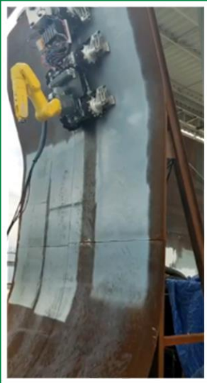
ROBÔ DE DIFÍCIL ACESSO
